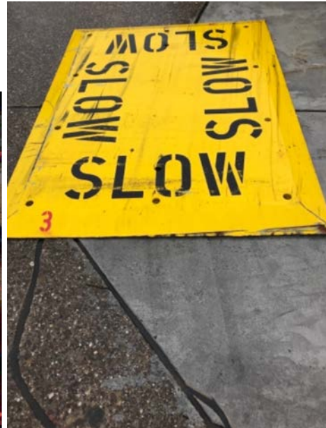
Die Stahlplatte als erste provisorische Abdeckung eines Schadens.
